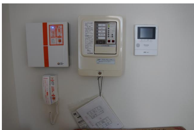
自動火災報知機・非常通報装置
