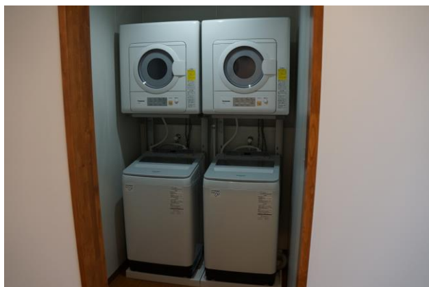
初度調弁 補助金で購入した洗濯機
